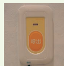
緊急通報装置
